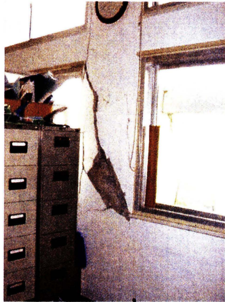
写真6 南面1階中柱のせん断破壊（屋内側）
