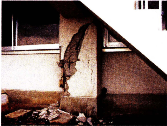
写真5 南面1階中柱のせん断破壊（屋外側）
