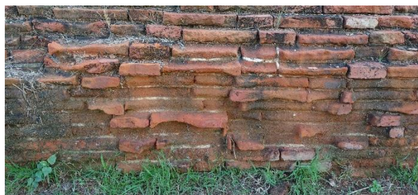
図5 修復レンガの表面剥落 (2022年11月撮影)
