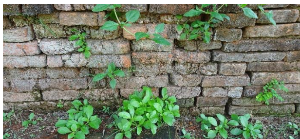
図4 修復レンガのエフロレッセンス (2022年11月撮影)
