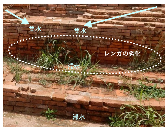
図1 修復レンガの劣化と植物繁殖 (2014.8.24 撮影)
