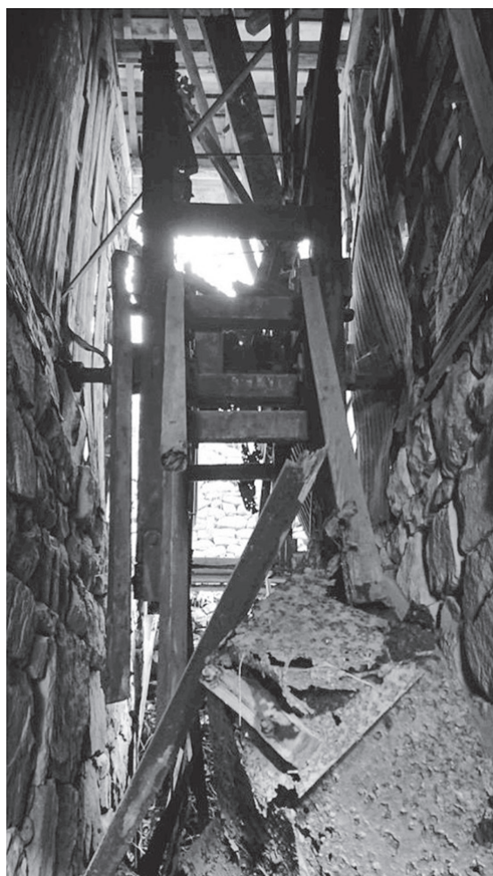
写真16 現在の水車(金属製の部分が腐食している。)
