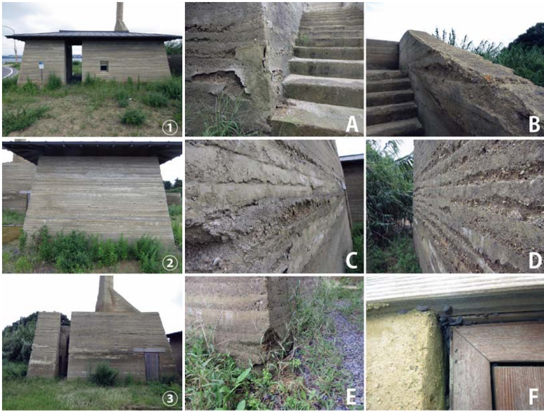
写真 2.3.1 竣工から5年後の風雨・虫害被害の様子 (①～③：全体、A～F：詳細)
