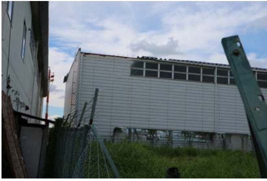
(c)被災建物 B 外観
