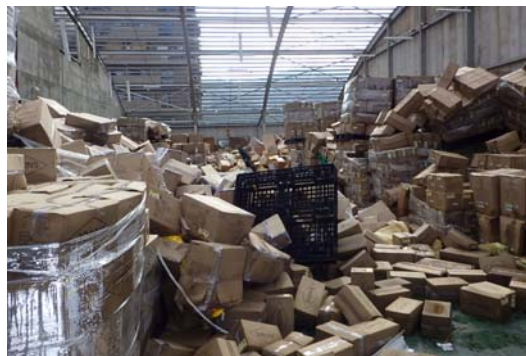
(b)被災建物 A の内部
