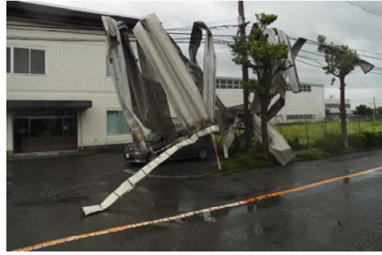
(d)被災建物 B の屋根ふき材(鋼板)の飛散状況
