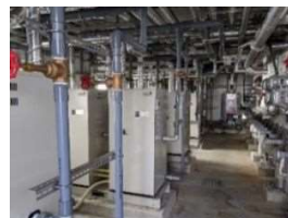
チラー・ボイラー
