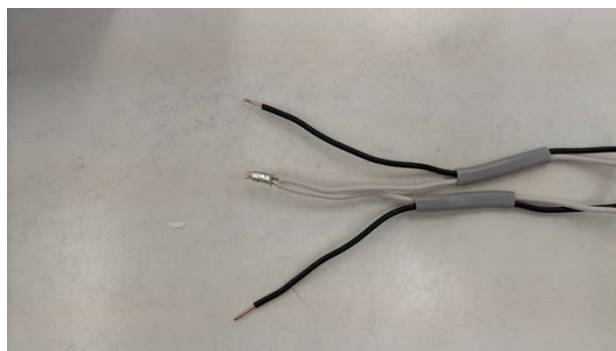
図 2. リングスリーブ接続された VVF ケーブル
