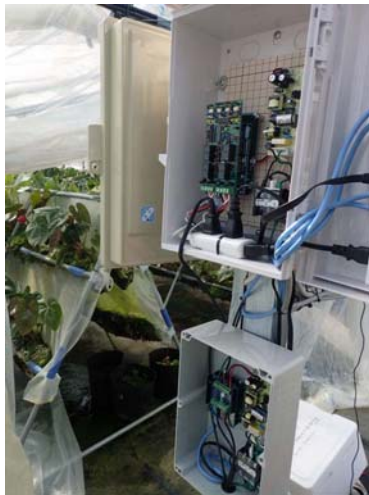
図6 低コスト二層カーテン制御システムの設置状況
