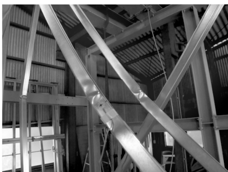
写真 9. 試験体 1-2 の終局状況 (ブレース材の座屈)
