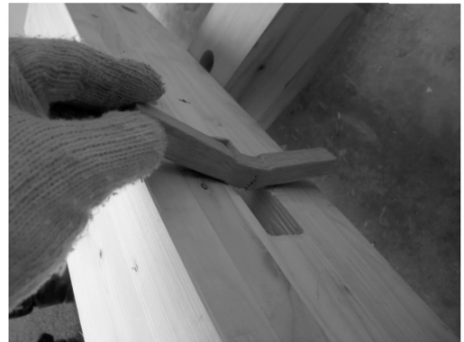
写真 5. 鼻栓の折れ曲がり (試験体 1)
