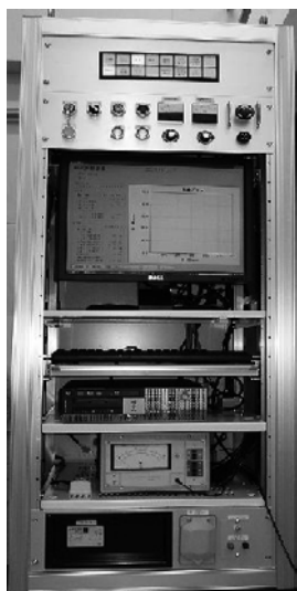
図 5. 風洞運転の操作盤
