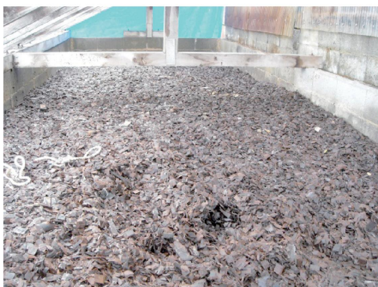
写真3 改修前の脱臭槽内部（充填物：広葉樹のウッドチップ）
