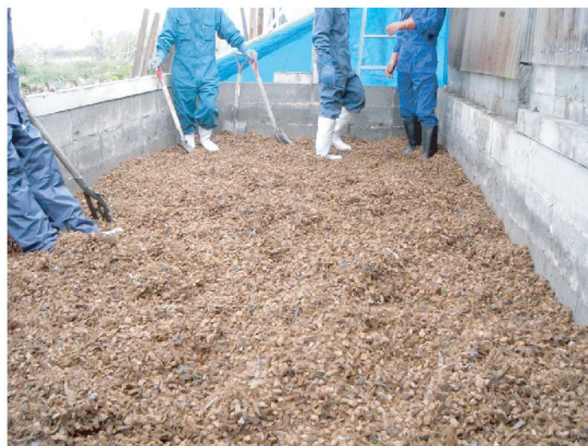
写真4 改修後の脱臭槽の内部（充填物：ヤシのハスク）
