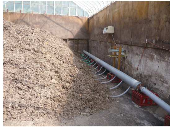
写真8 新しい発酵方法による1次発酵層とエアレーション装置
