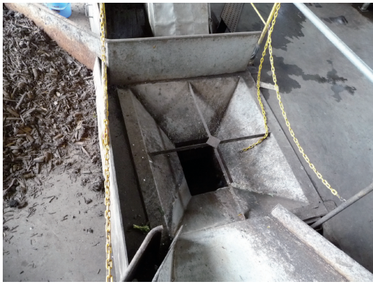
写真5 生ごみの投入口
