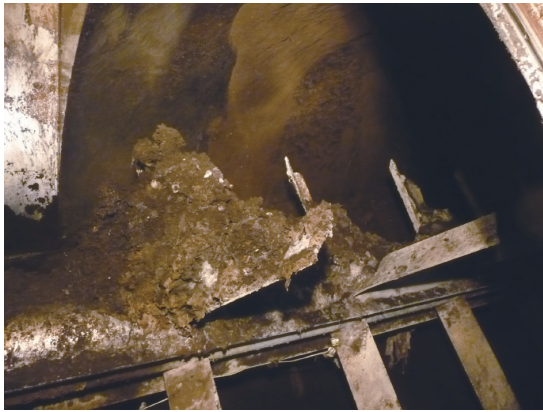
写真7 発酵装置の内部の様子
